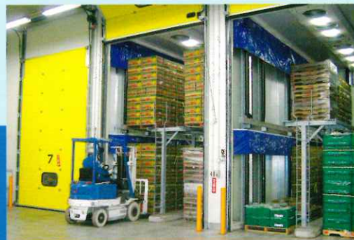
大阪 青果センター 平成20年4月稼働 パナ追熟設備
